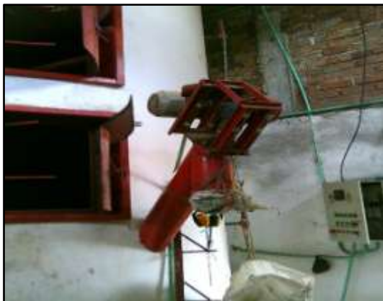
Figura 22. Instalaciones eléctricas en el silo
