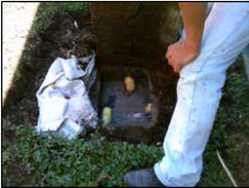
Figura 14. Trampa de grasas sin mantenimiento
