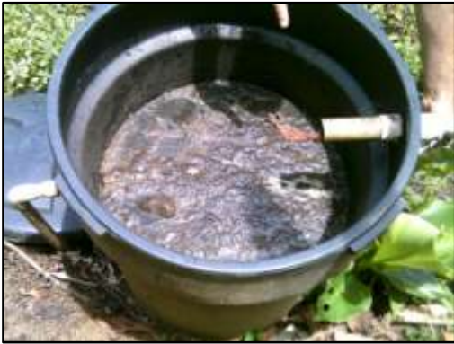
Figura 15. SMTA sin mantenimiento
