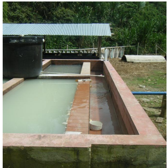
Foto 5. Tanque de dosificación de cal a la salida del sedimentador.
