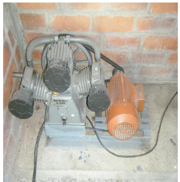
Foto 19. Compresor de los tanques de aireación.
