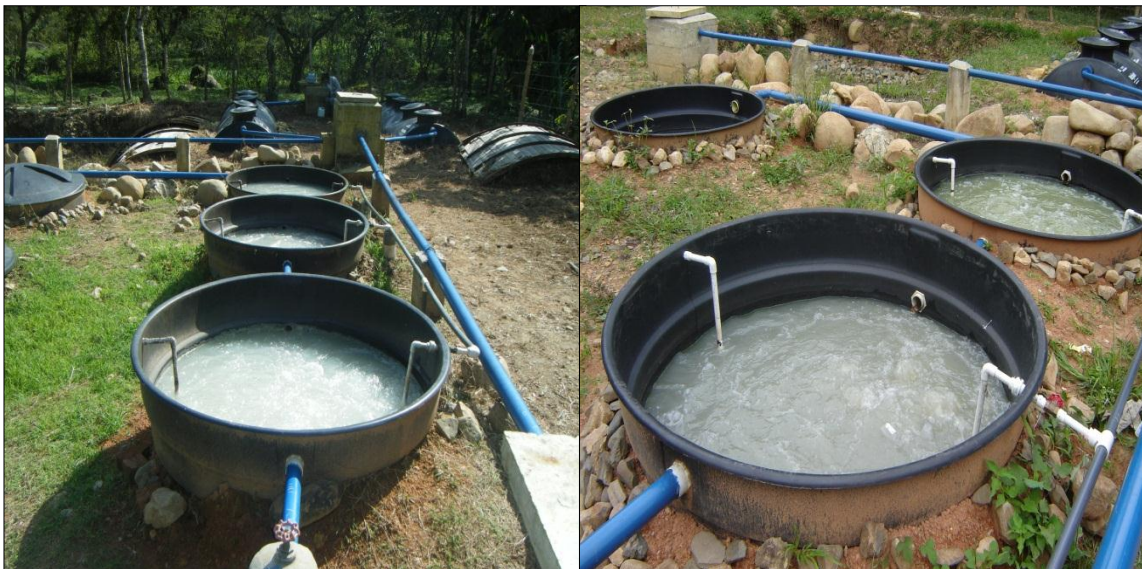
Foto 7. Tanques de aireación.
