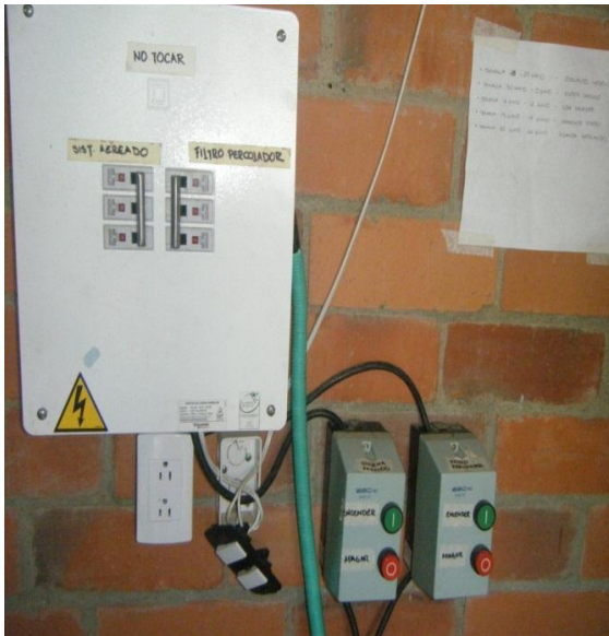
Foto16. Interruptores de sistema de aireación y filtro percolador.
