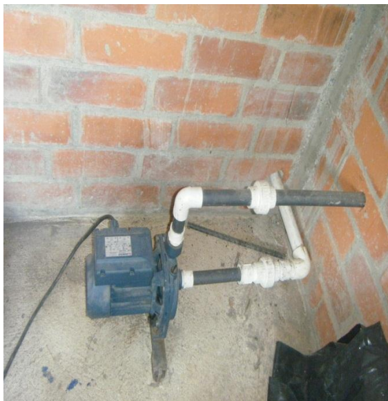
Foto 18. Equipo de bombeo del filtro percolador.
