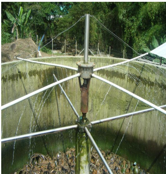
Foto 13. Taponamiento de orificios del brazo distribuidor en el filtro percolador.
