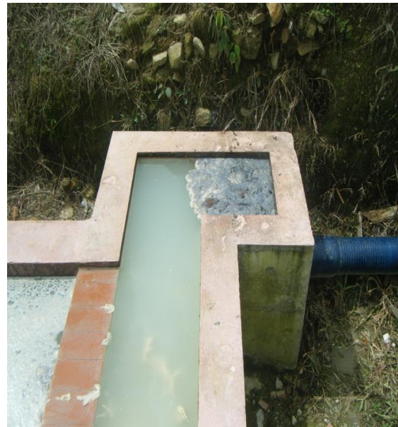
Foto 2. Resuspensión de mancha en la entrada al sedimentador.
