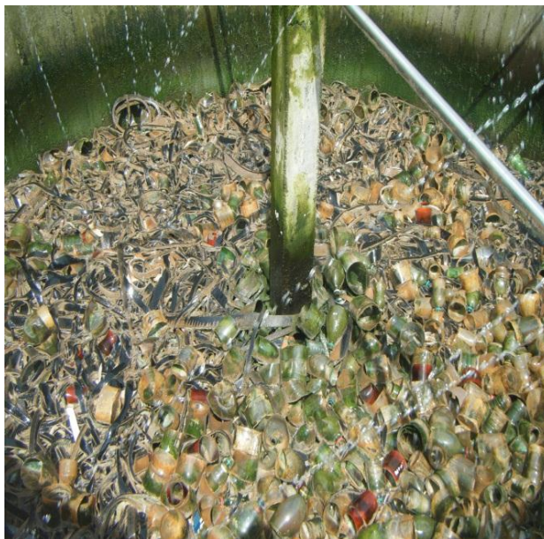
Foto 15. Material de soporte en el filtro percolador.
