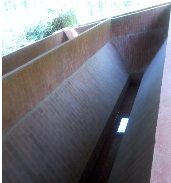
Figura 13. Paredes del sedimentador de mancha
