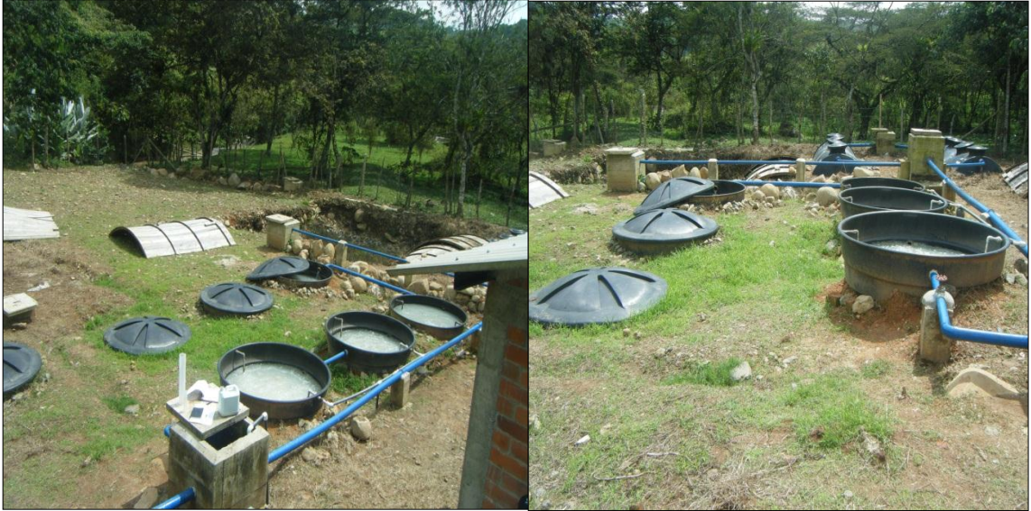
Foto 6. Sistema de aireación.
