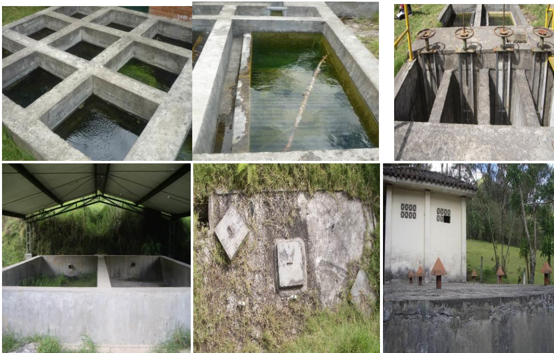
Figura 4. Infraestructura de la planta de potabilización del agua.
