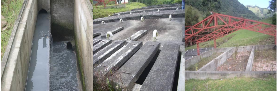
Figura 8. Planta de tratamiento de aguas residuales “PTAR”.
