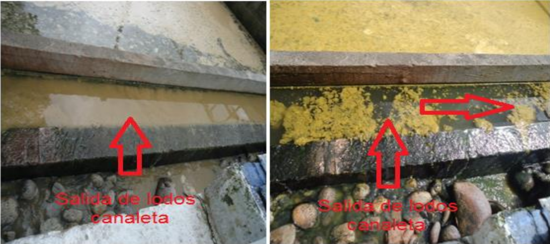
Ilustración 13. Salida de lodos, canaleta sedimentador
