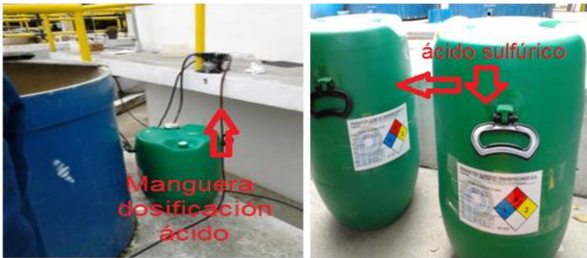
Ilustración 21. Dosificación de ácido sulfúrico en el tanque de regulación.
