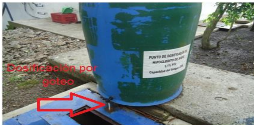
Ilustración 10. Dosificación de hipoclorito de sodio
