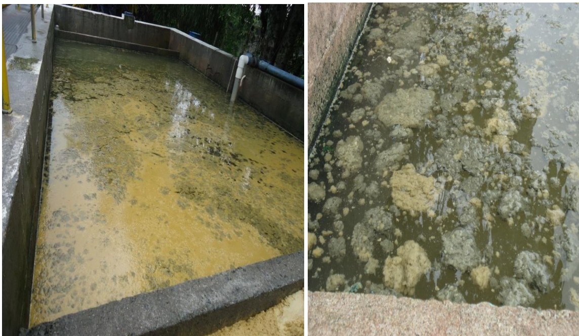
Ilustración 15. Material flotante en el clarificador secundario
