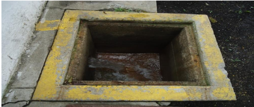
Ilustración 9. Efluente de la PTAR
