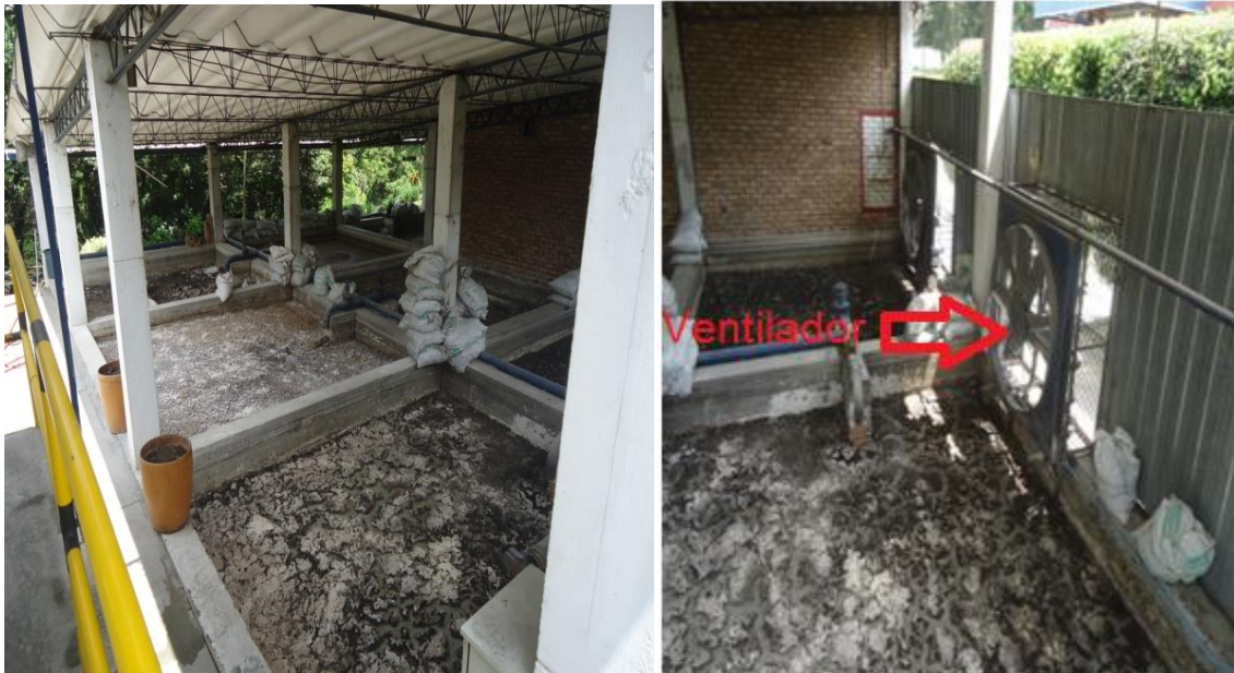
Ilustración 7. Lechos de secado y ventiladores
