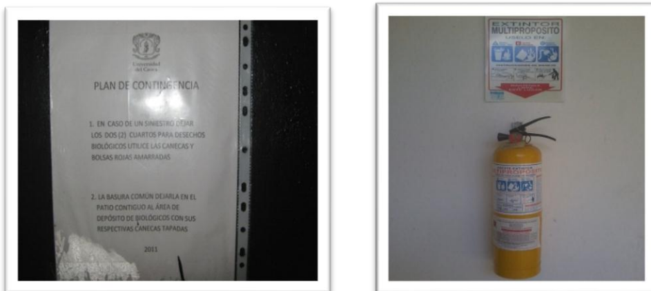
Figura 18. Plan de contingencia y extintor área de almacenamiento
