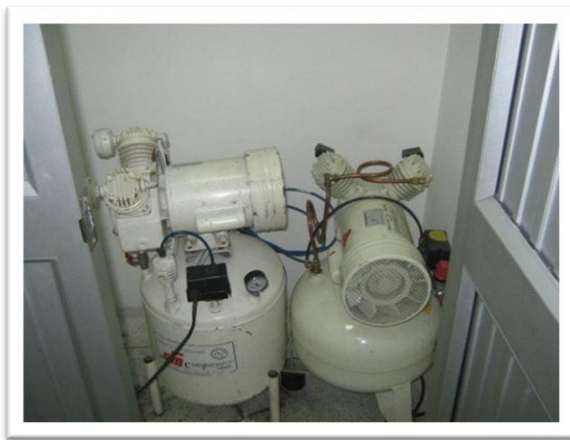
Figura 23. Cuarto de compresores.
