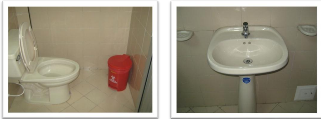
Figura 22. Programa de tecnologías limpias, uso de baterías sanitarias y griferías ahorradoras.
