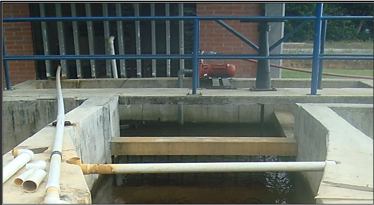
Fotografía 2. Detalle Cámara de llegada (Punto de muestreo)
