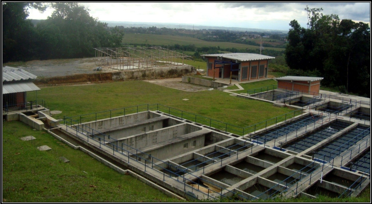
Fotografía 1. Vista general de la planta de tratamiento zona norte "Planta Palacé"
