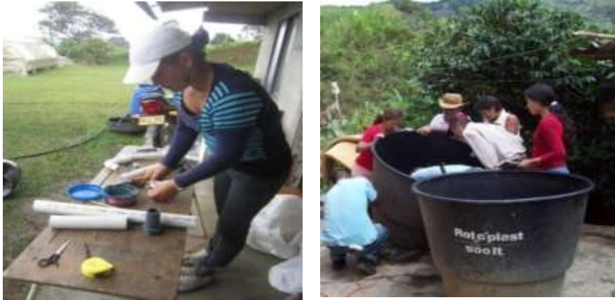
Figura 11. Instalación del SMTA en la vereda de la Rejoja
