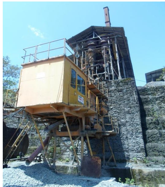
Dispensador de aceite quemado para producción de mezcla asfáltica
