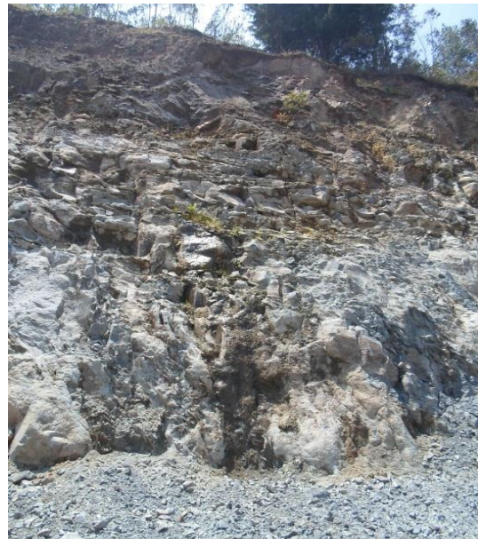
Agua drenando del talud explotado
