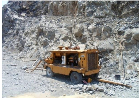
Compresor que suministra aire al Track Drill para trabajar con presión
