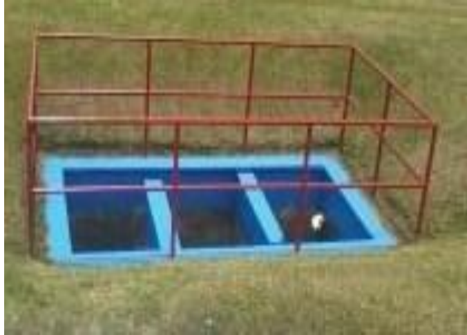
Imagen A3.5. Tanque de aireación.
