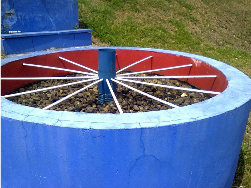
Imagen A3.3. Filtro percolador.
