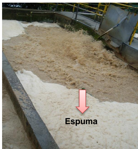
Ilustración 20. Tanque de aireación con presencia de espuma
