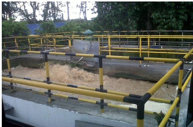
Ilustración 6. Tanque de aireación
