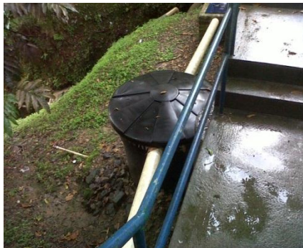
Ilustración 12. Tanque de contacto
