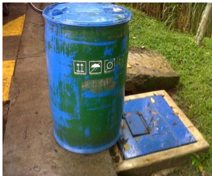
Ilustración 11. Dosificación de hipoclorito de sodio
