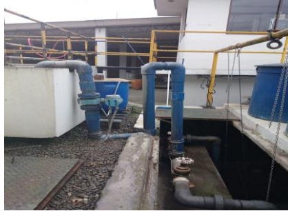
Ilustración 5. Estación de bombeo de agua residual
