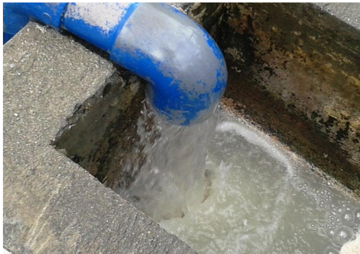
Ilustración 17. Estructura de entrada al tanque de aireación
