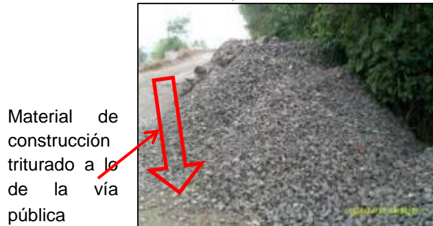
Figura 20. Materiales de construcción sobre la vía pública.
