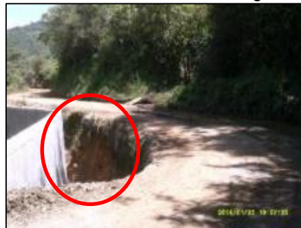
Figura 27. Ausencia de señalización y demarcación de las áreas de riesgo en la vía
