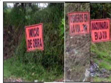
Figura 41. Señalización informativa en la vía.
