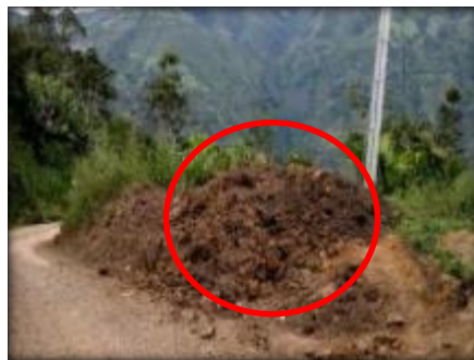
Figura 22. Material de excavación sin su debida demarcación y conformación.
