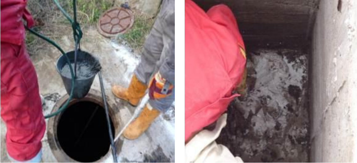
Figura 20 y 21. Retiro y tratamiento de los residuos sólidos y lodos de las cámaras de sedimentación.
