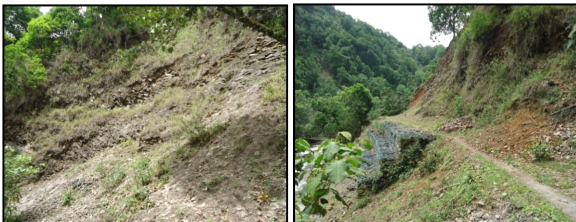
Material de los taludes adyacentes al Río Palacè cerca de la bocatoma en zona con alta pendiente.
