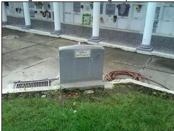
Figura 12. Grifo de agua potable.
