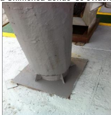
Figura 28. Base de la Chimenea donde se evidencia cero vertimientos
