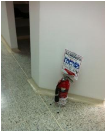
Figura 10. Extintor de CO2 sin demarcación
