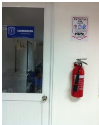
Figura 7. Extintor de CO 2 con dificultad para su maniobra por el mecanismo de soporte y altura
