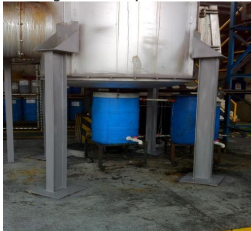
Figura 31. Tanques de lodos
