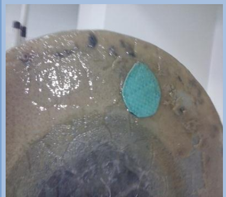
Foto 15. Observación: desprendimiento de la biopelícula Fecha: 24 de septiembre 2014
