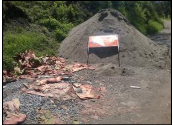
Figura 39. Material aledaño a la vía sin conformar, residuos de construcción sin acoplamiento y señalización en lugar poco visible
