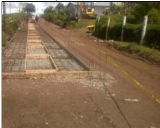
Figura 36. Construcción de placa-huella con acordonamiento pero sin señalización.
