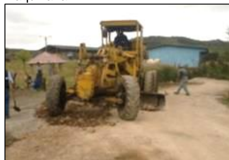
Figura 14. Ausencia de señalización y dotación de elementos de protección personal durante la etapa de conformación y manejo de maquinaria.
