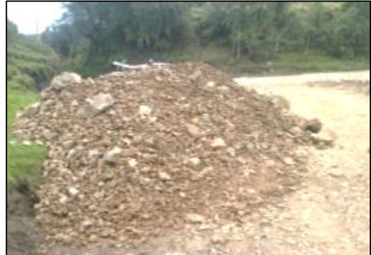
Figura 16. Material sobrante dispuesto sobre la vía pública.
