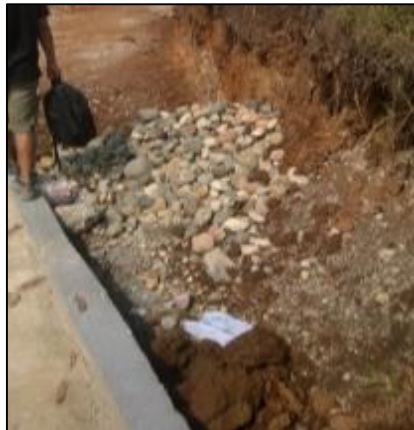
Figura 46. Material sobrante de construcción, aledaño a la vía.
