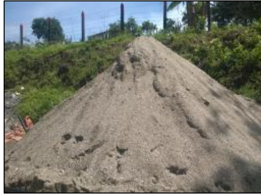
Figura 17. Material de obra sin su manejo integral debido.
