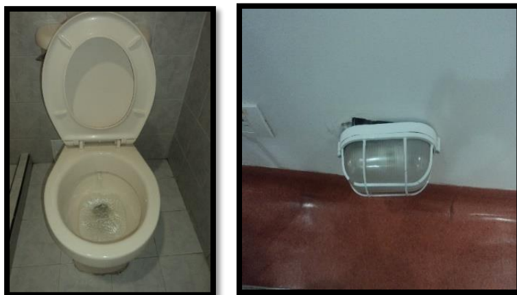
Figura 29: Inodoro con fuga de agua y bombilla en mal estado
