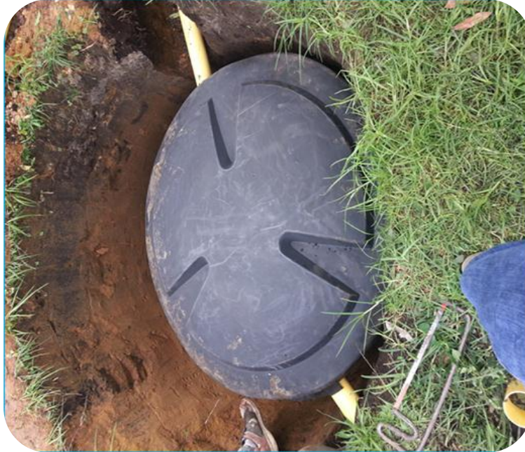
FOTOGRAFÍA A4. 4. TANQUE SÉPTICO
