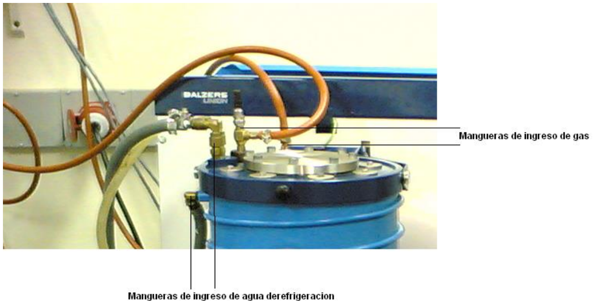
Figura 16. Conexiones a la cámara de Vacío
