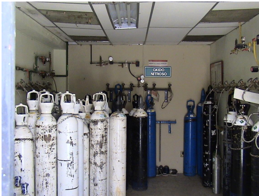
Figura 1. Fotografía central de gases medicinales Hospital S.L.V.
