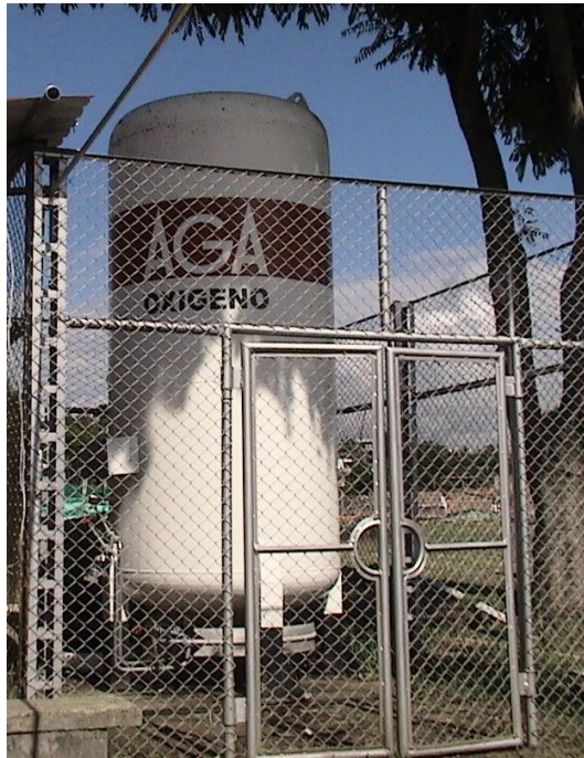
Figura 2. Fotografía del tanque criogénico del Hospital S.L.V.
