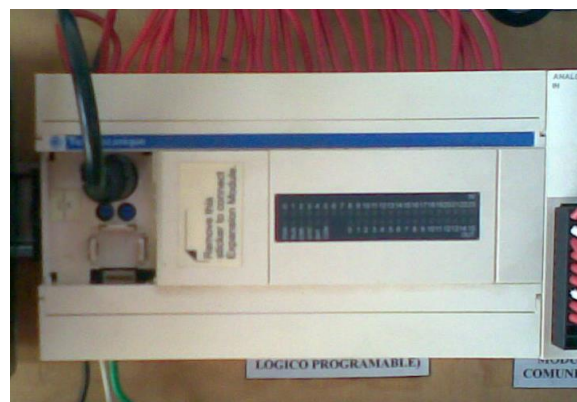
Figura 26. Fotografía del PLC TWIDO
