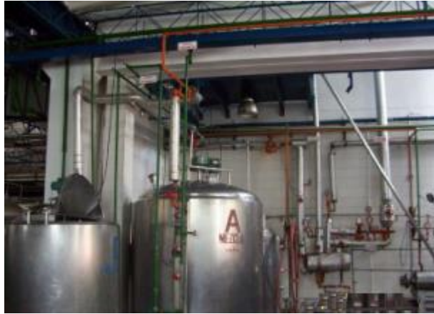
Figura 6.2. Tuberías sin aislante térmico en la zona de producción de arequipe
