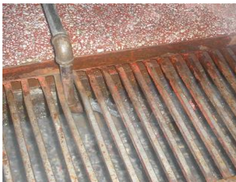
Figura 6.6. Desagüe del intercambiador de calor zona de pasterización
