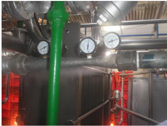
Figura 5.1. Tubo de Venturi en zona de pasteurización.
