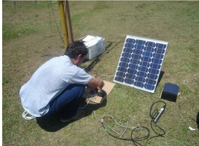
Figura 31. Pruebas realizadas con paneles solares y baterías para evaluar el rendimiento del sistema de alimentación autónomo
