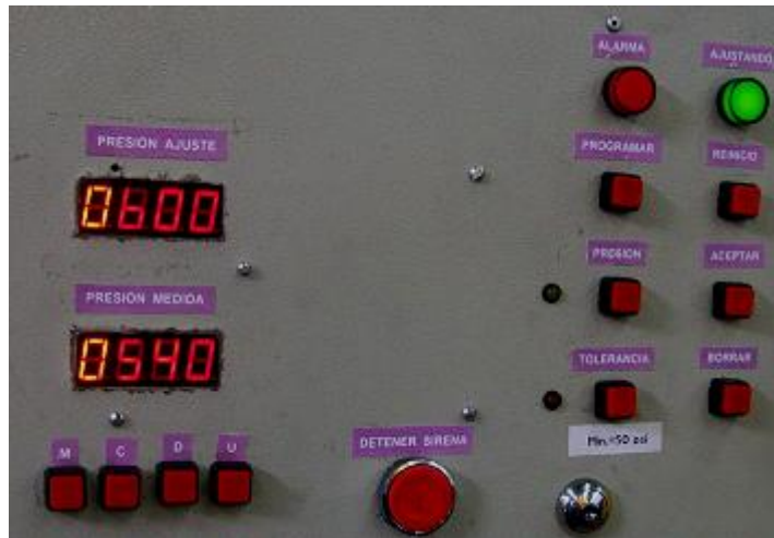
Figura 47. Momento en el cual el sistema de control de presión va a realizar la corrección debido a que la presión medida a alcanzado el mínimo valor permitido (540 psi).
