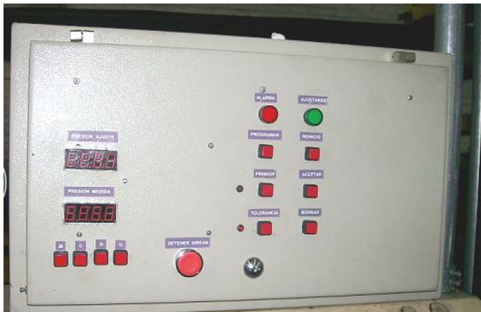
Figura 40. Vista frontal del panel de control del sistema de control de presión.
