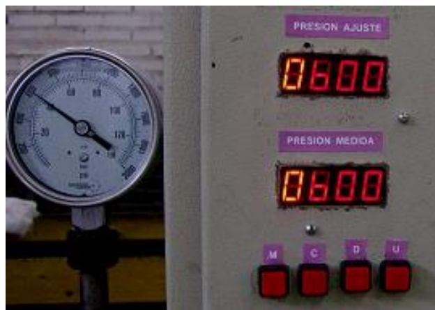
Figura 46. Prueba del sistema de control de presión implementado programado con una PRESIÓN AJUSTE de 600 psi, y una tolerancia de 60 psi.
