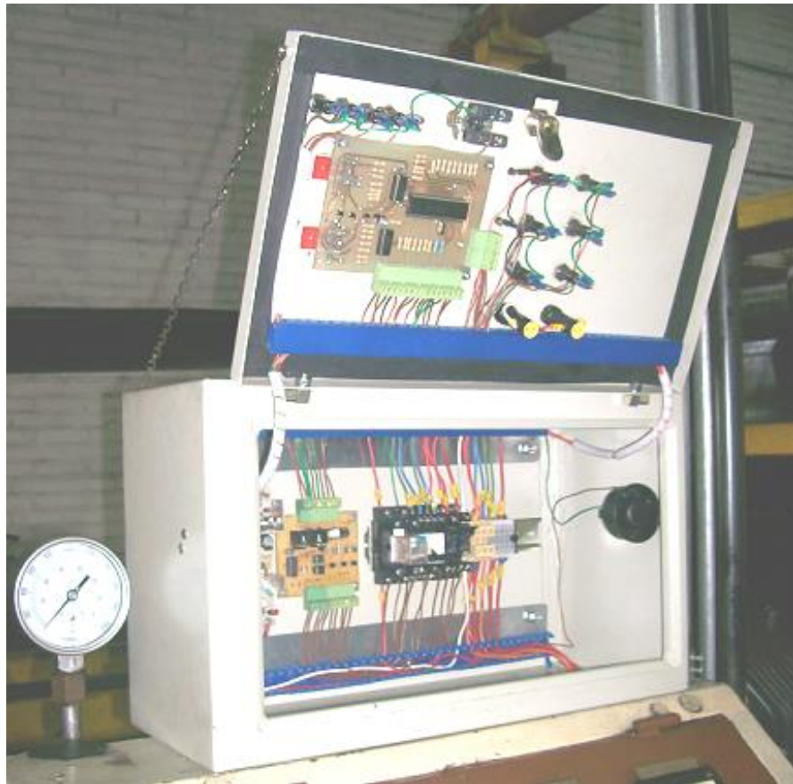
Figura 41. Vista interna del cofre metálico donde se instaló en sistema de control implementado.
