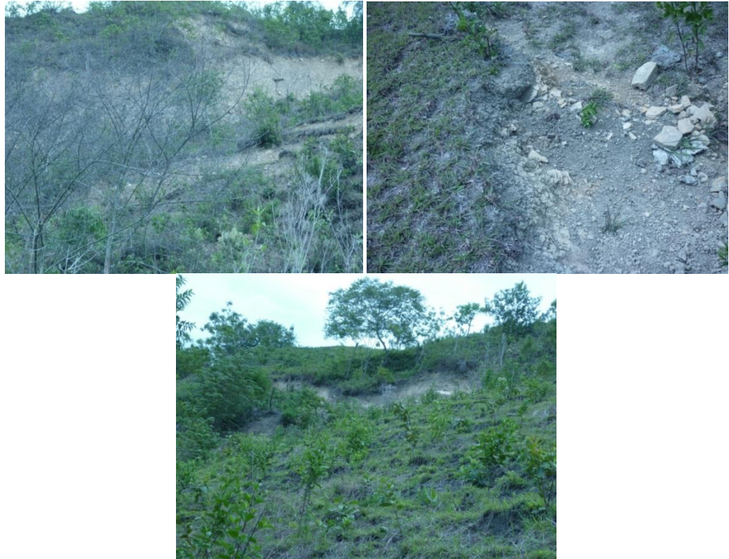
Figura 3.39 – Fotografía de proceso de erosión, fracturamiento y desprendimiento de roca.
