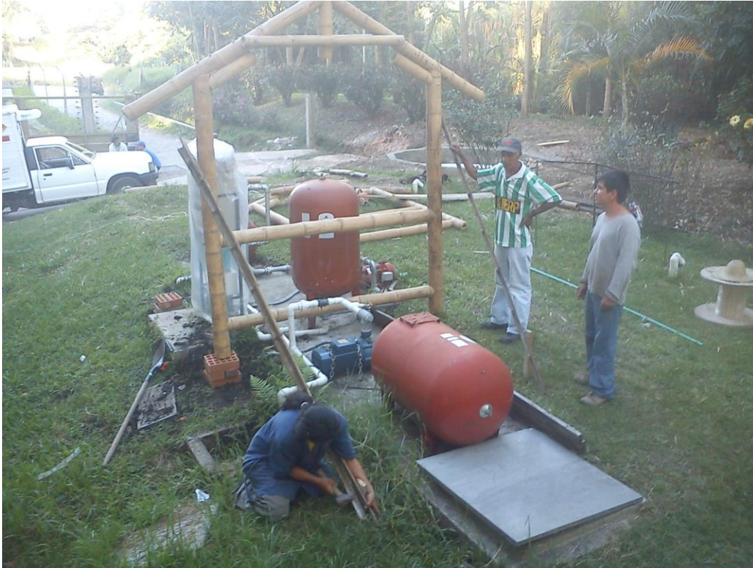
Figura 3.7 Sitio asignado para el cuarto de bombas
