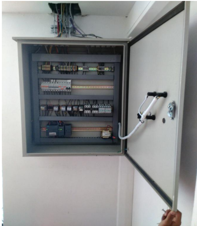
Figura 3.13 Tablero de control con PLC siemens S7-1200
