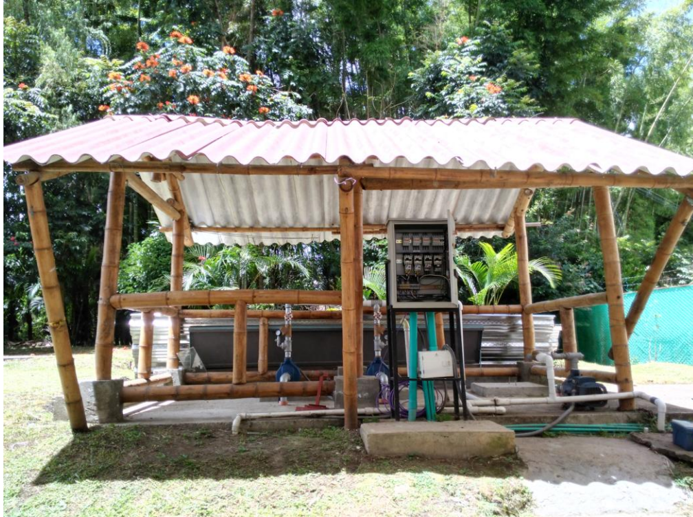
Figura 3.15 Cuarto de máquinas terminado.
