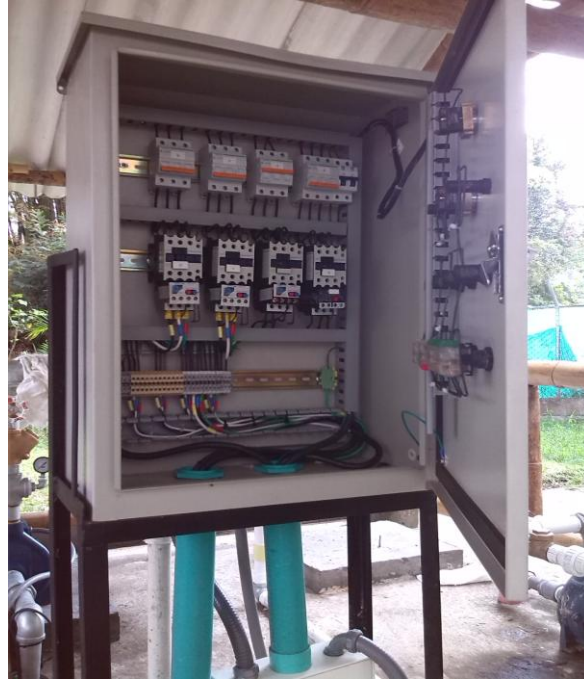
Figura 3.11 Tablero de potencia para variador de velocidad y motores impulsores.
