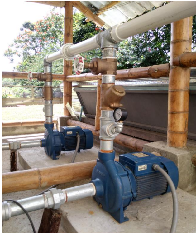
Figura 3.10. Conexión de tubería de succión y bombeo.
