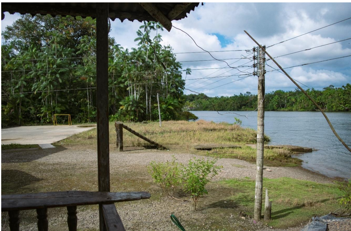
Fotografía 10. La red eléctrica. (Fuente: Elaboración Propia)
