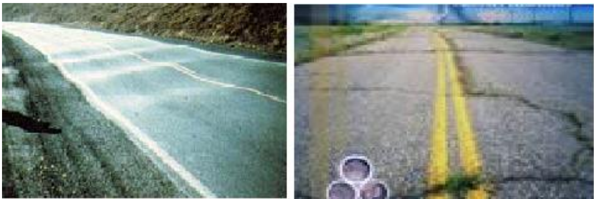
Figura 6. Problemas típicos del asfalto cuando es puesto en la vía.
