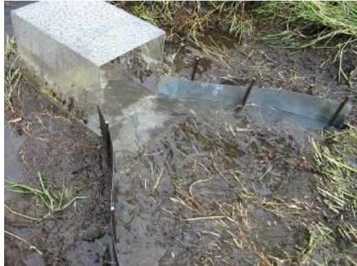
Figura 9. Instalación de parcela de Escorrentía
