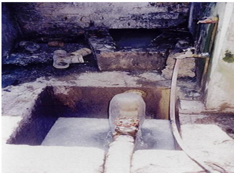
Figura 5. Agua residual proveniente de los tanques de sedimentación que es arrojada directamente a la quebrada Abejonales
