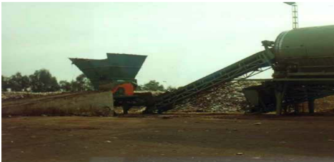
Fotografía 3. Areas de recepción, picado y selección de residuos de la Planta de compostaje Ciudad Limpia, de Barcelona
