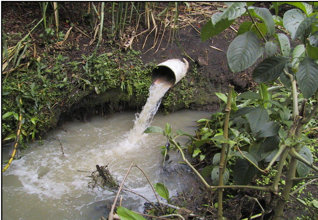
Foto 6. Descarga de aguas residuales en la estación San Bernardino
