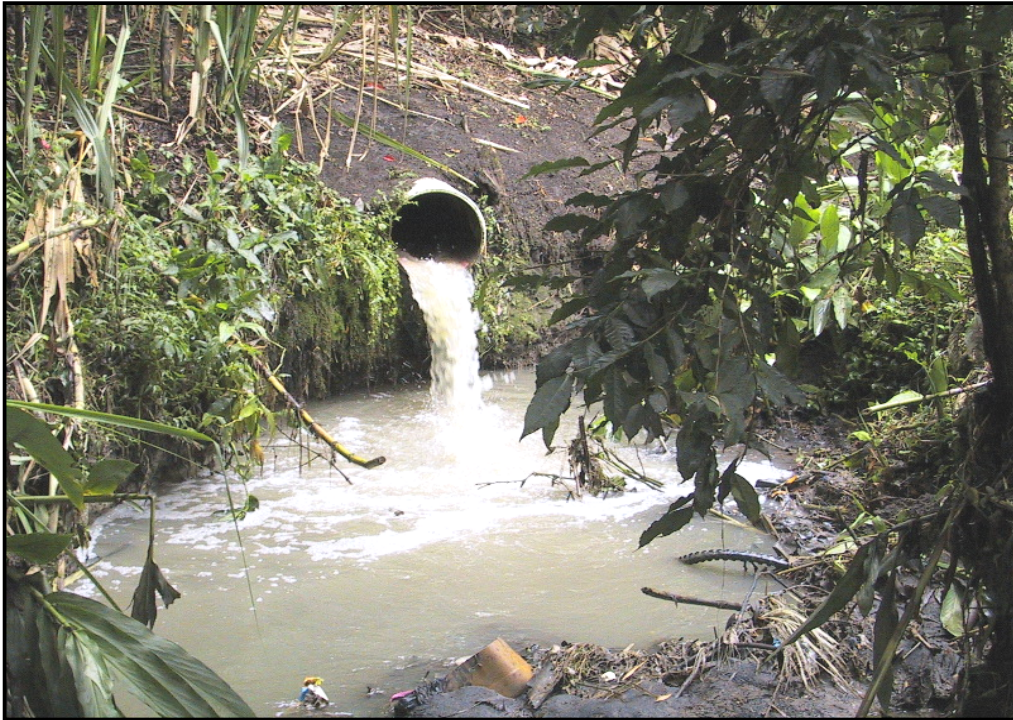
Foto 5. Descarga de aguas residuales a la quebrada Quitacalzón, estación San Bernardino
