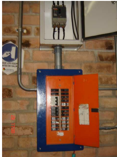
Figura 95. Fotografía de las fases eléctricas R, S y T
