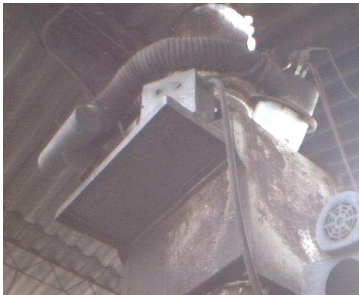
Figura 4. Cámara de postcombustión.
