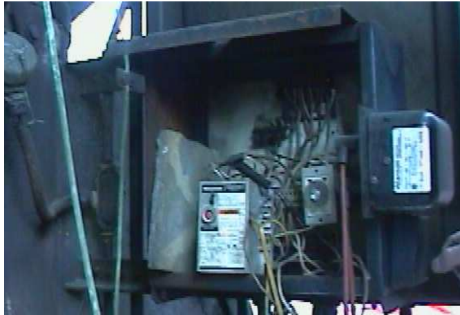
Figura 42. Controles de combustión
