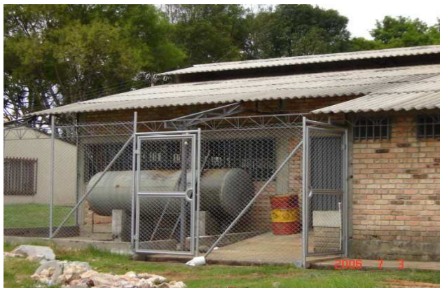
Figura 90. Fotografía del tanque de combustible.
