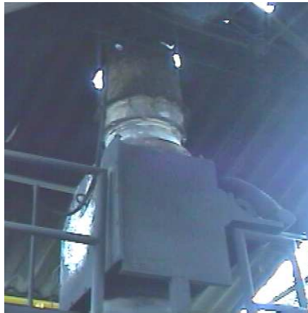
Figura 36. Tercera cámara, la cual es la segunda cámara de post-combustión del horno.
