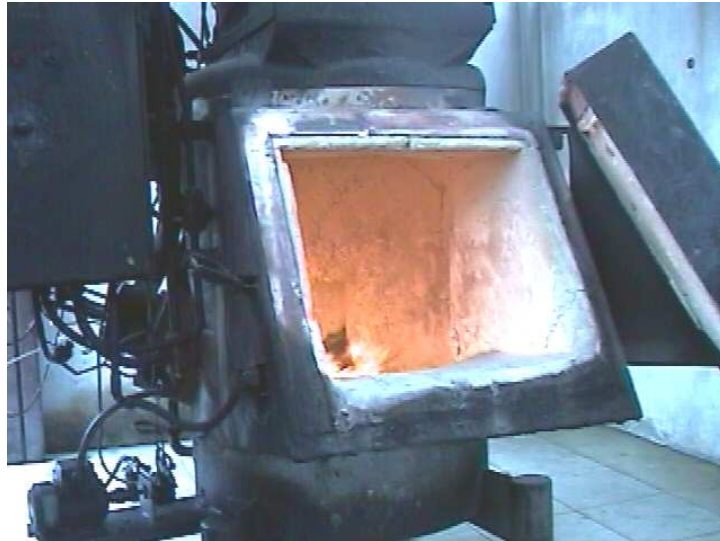
Figura 3. Combustión en la primera cámara.
