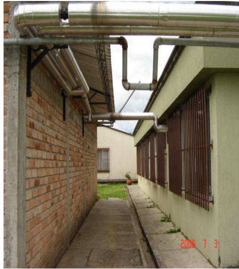
Figura 93. Fotografía de la red de vapor.
