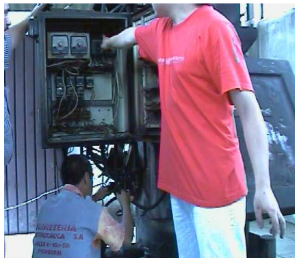
Figura 37. Caja de controles del incinerador
