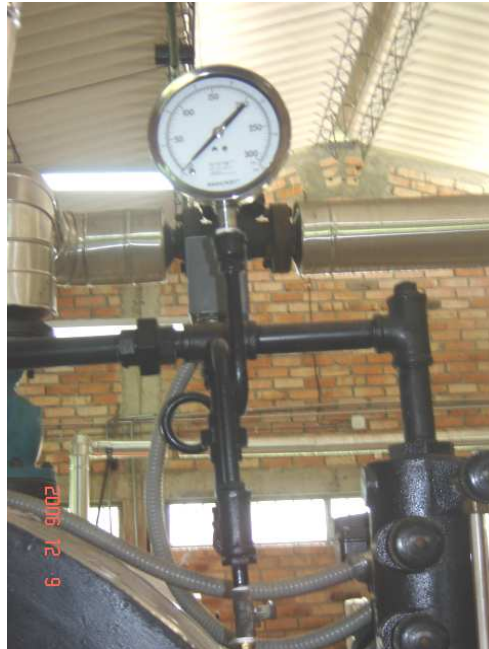
Figura 17. Instrumento de nivel para líquidos en la caldera del HSLV
