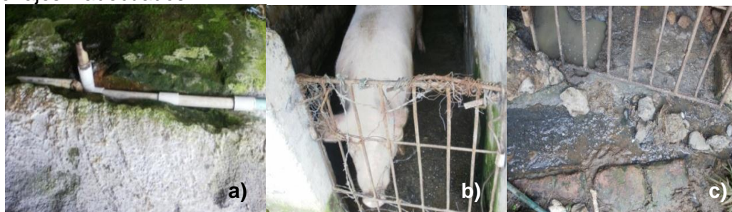
Figura 19. Infraestructura porcícola en la IEAP: a) Redes hidráulicas, b) Puertas, c) Drenajes inadecuados
