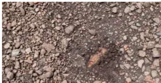
Ilustración 4.7. Perdida de capa de rodadura que permite evidencia saturación de la subrasante.
