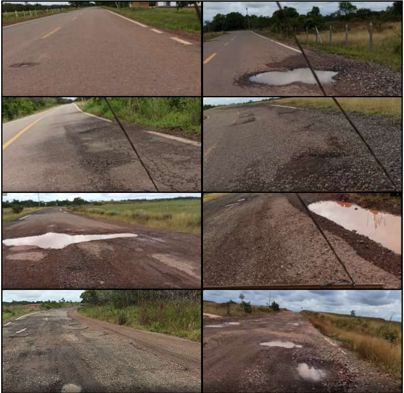
Ilustración 4.2. Deterioros presentados e incremento de su severidad
