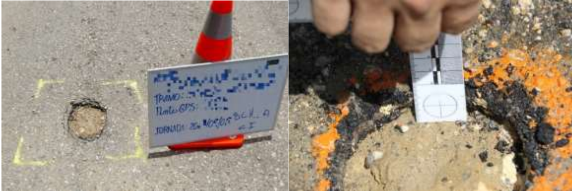
Ilustración 4.12. Zona con capa de rodadura de bajo espesor.
