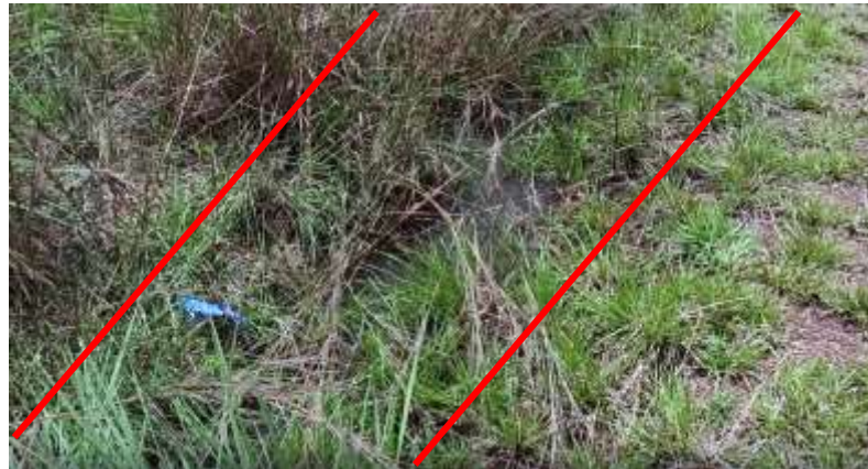
Ilustración 4.6. Cunetas naturales taponadas por falta de rocería y limpieza
