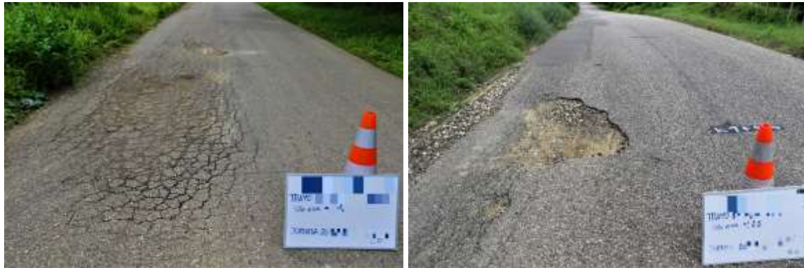
Ilustración 4.10. Levantamiento de daños.
