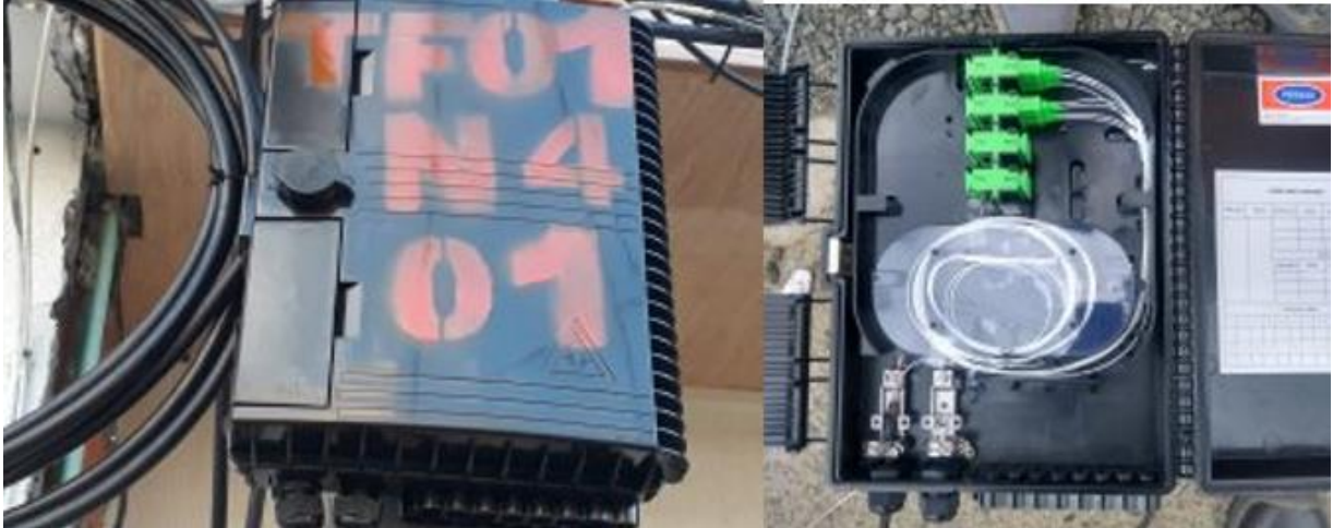
Figura 3.15 Interior y cubierta Exterior de una FAT
