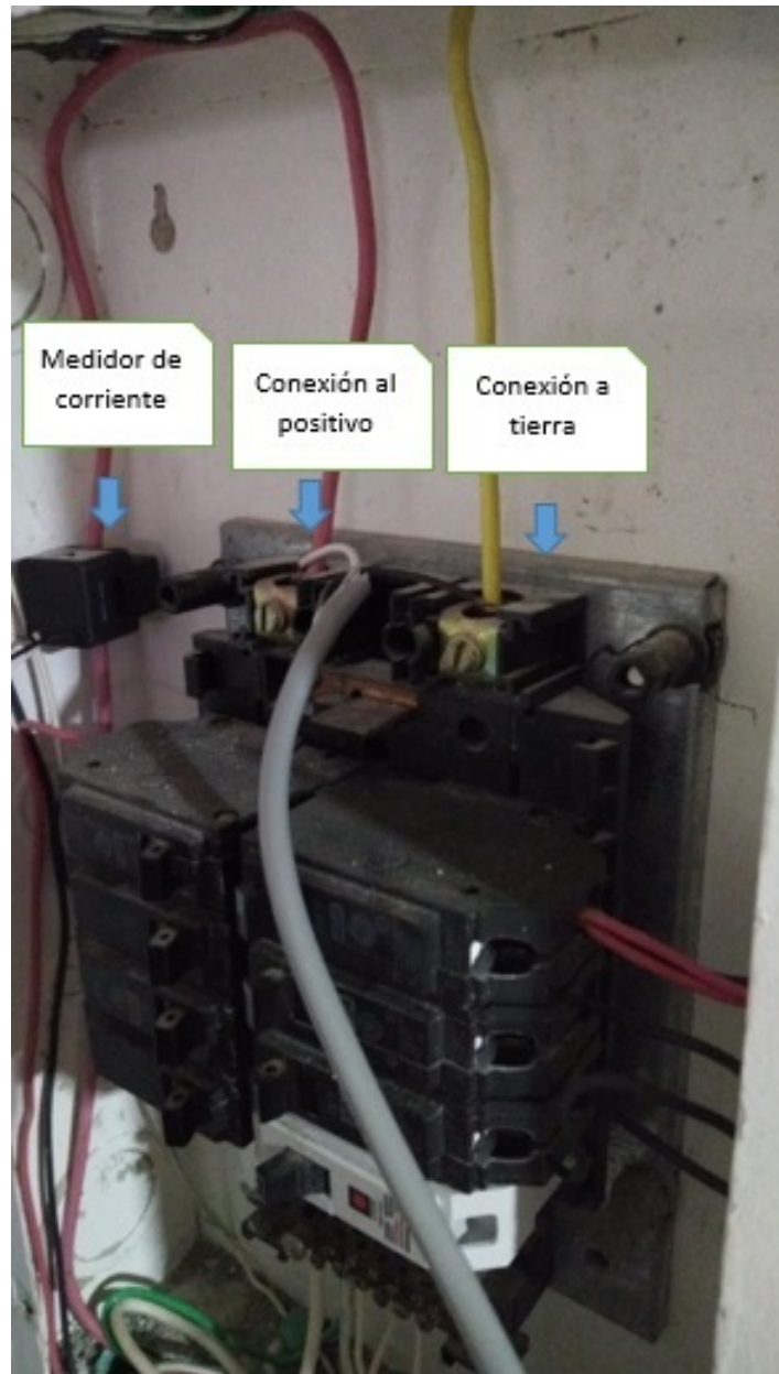
Figura 6: Conexión medidor inteligente a caja de fusibles
