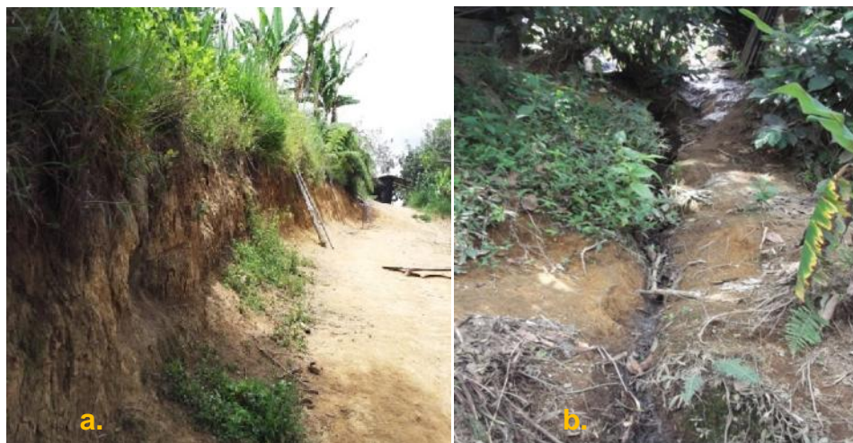
Figura 15. Problemas de erosión finca El Pino; a. erosión taludes, b. erosión escorrentía.
