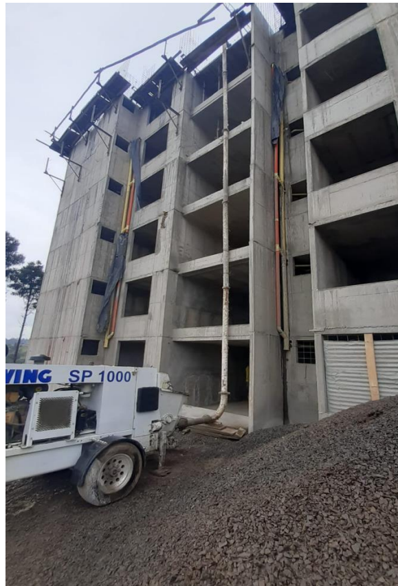
Figura 37. Tubería y Bomba Hidráulica Para Concreto.
