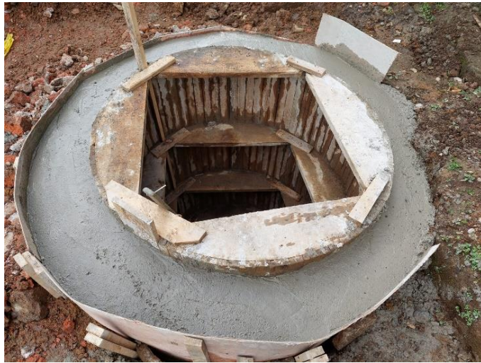
Ilustración 95 Cilindro cámara de inspección - Fuente: propia
