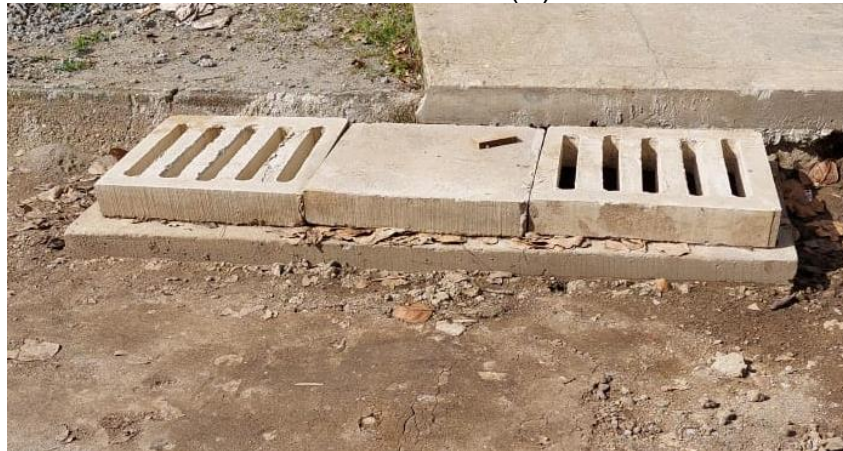
Ilustración 66 Sumidero en concreto 21 Mpa - Fuente: propia
