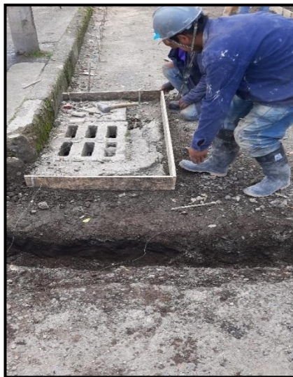
Imagen 45 Sumidero primer carril
