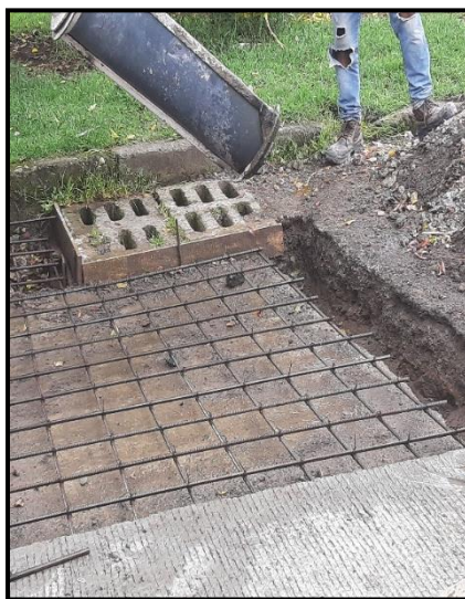
Imagen 46 Rejilla y sumidero segundo carril
