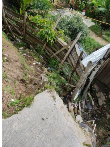
Figura 83. Talud con fallas y agrietamientos
