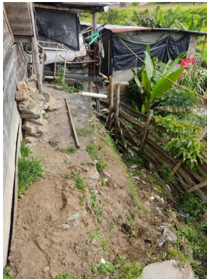
Figura 26. Talud con posible riesgo de colapso
