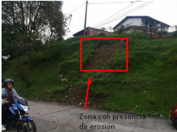
Figura 78. Deslizamiento del talud por presencia de erosión y se evidencia presencia de escombros
