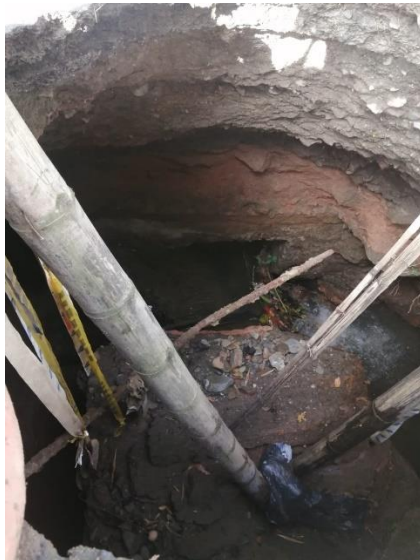
Figura 80. Profundidad de la socavación en el tablero del puente
