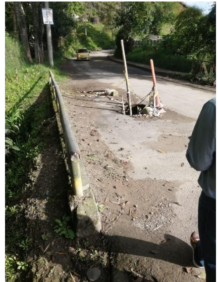
Figura 81. Socavación presentada en el tablero del puente con posible riesgo
