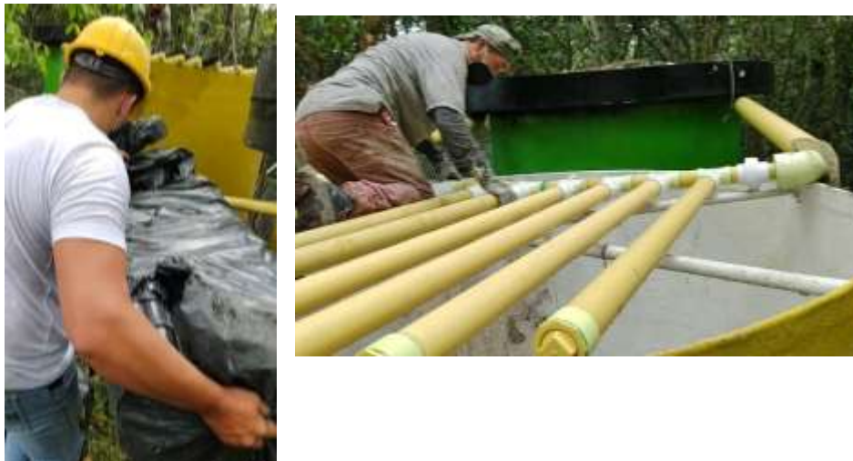
Ilustración 16. Instalación del filtro percolador. A) Ingreso de rosetones plásticos al filtro percolador. B) Flautas en PVC del filtro percolador. Fuente: Propia
