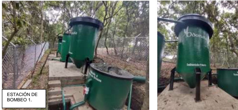
Ilustración 20 a) Desde la estación de bombeo se conduce el agua al sedimentador primario. b) Sedimentador primario. Fuente: Propia
