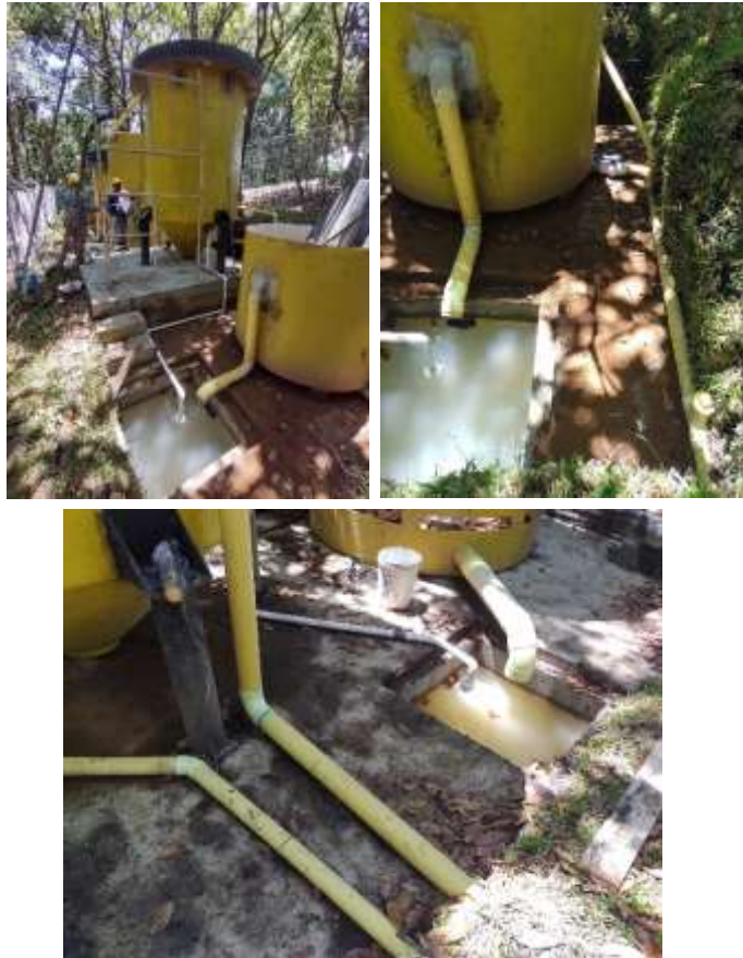
Ilustración 15. A) Instalación de los tanques trampa de grasa, sedimentador primario, filtro percolador y clarificador. B) y C) Se instala la tubería sanitaria correspondiente. Fuente: Propia
