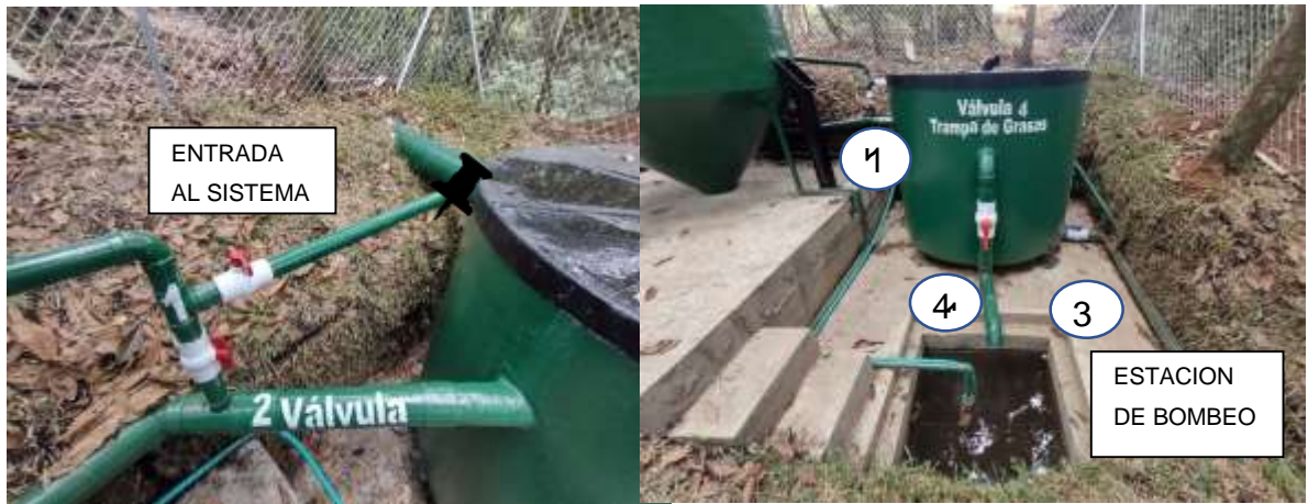
Ilustración 18 a) Entrada al sistema tubería 10". b) válvulas de manejo para trampa de grasas, desarenador y salida a la primera estación de bombeo. Fuente: Propia
