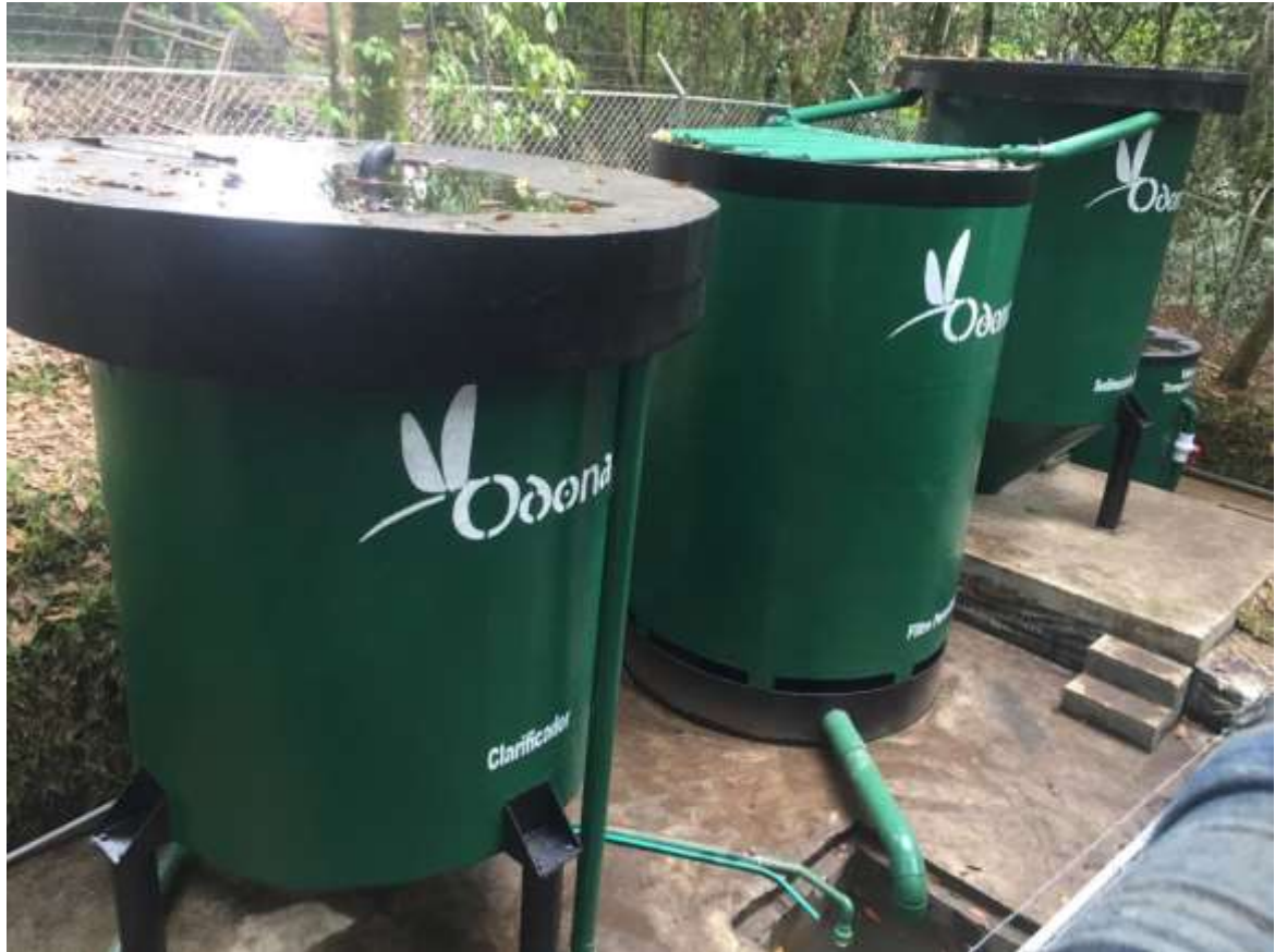
Ilustración 17. Sistema de tratamiento Bosques de Alhambra instalado. Fuente: Propia
