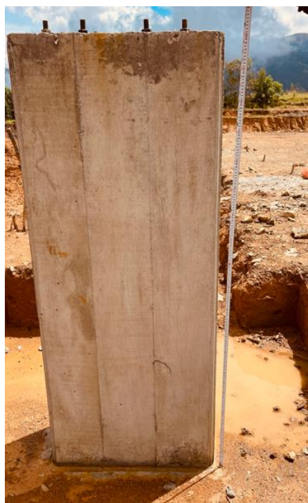
Imagen 40. Rectificación de medidas de Pedestales fundidos Escenario Deportivo San Antonio. Fuente: propia
