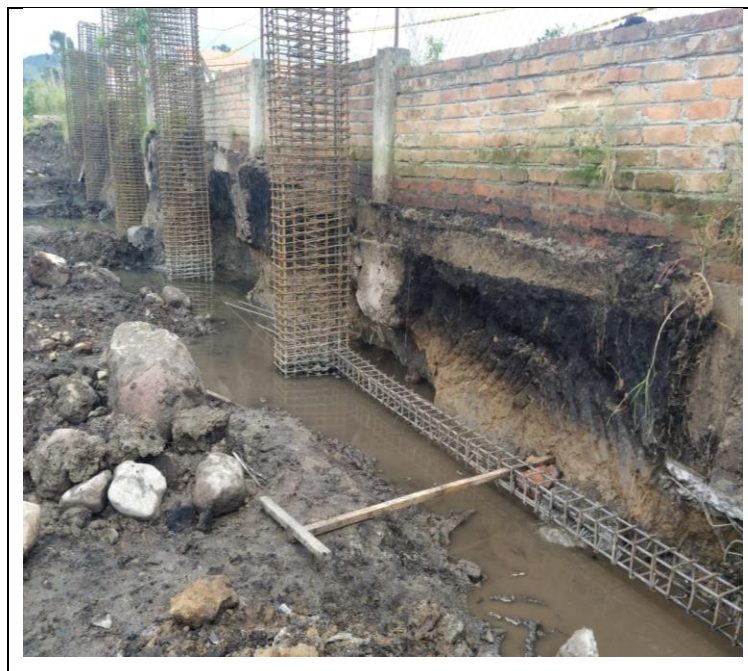
Figura 62. Nivel freático por encima de las zapatas
