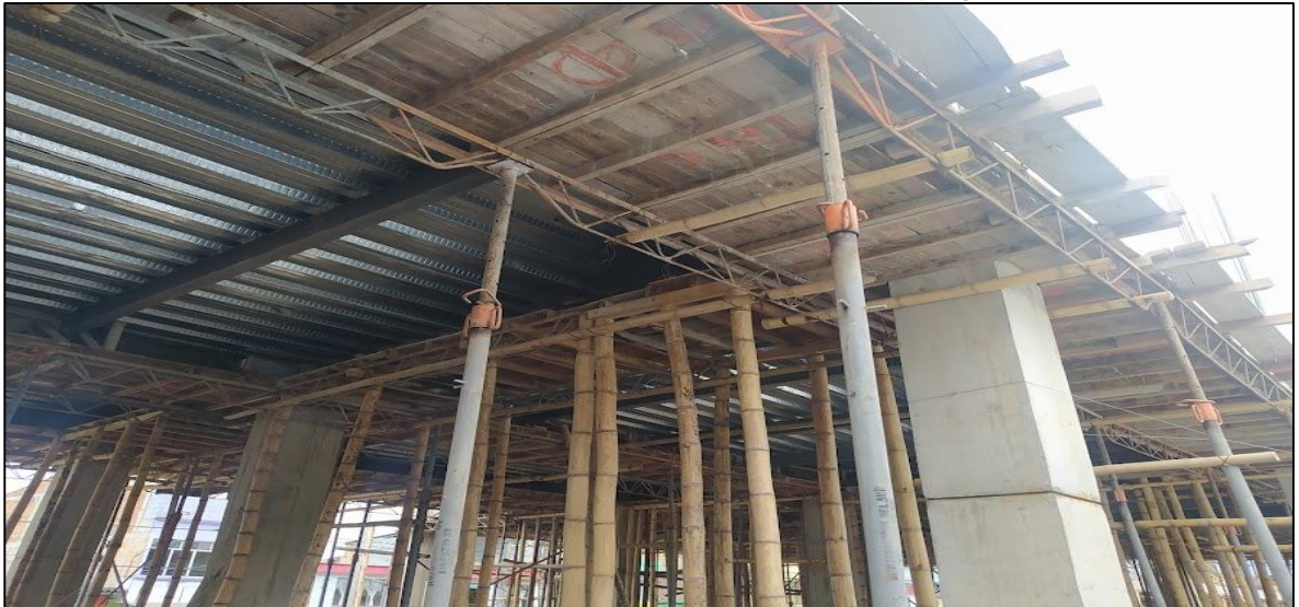
Ilustración 25. Foto tomada en obra, sistema de apoyo para losa de entrepiso y vigas aéreas.
