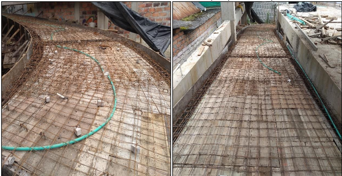
Ilustración 53. Foto tomada en obra, instalación de malla de acero para placa en rampa de acceso.
