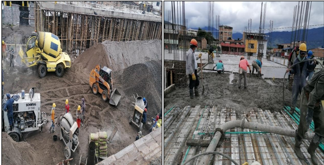
Ilustración 26. Foto tomada en obra, preparación del concreto, fundición, vibración y nivelación de losa.
