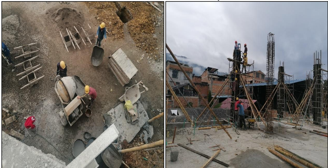
Ilustración 12. Foto tomada en obra, elaboración de concreto 3000 PSI y fundición de columnas.
