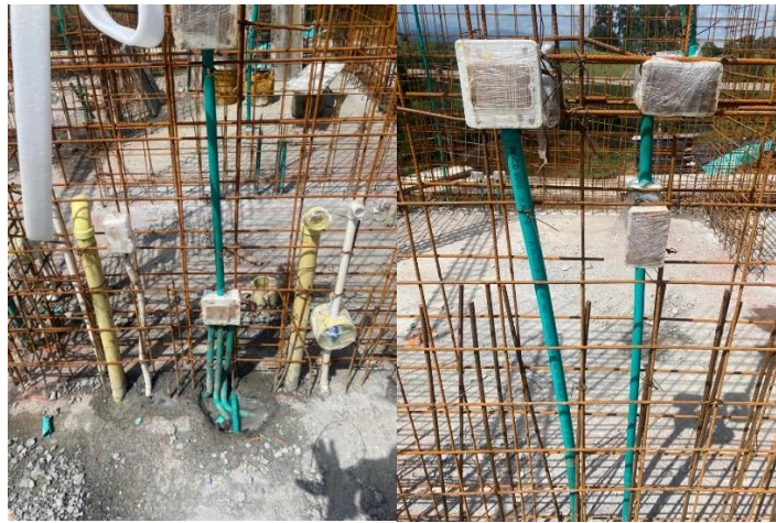
Ilustración 14. Puntos eléctricos y sanitarios protegidos Fuente: Elaboración propia
