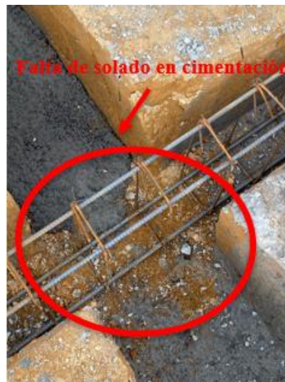
Ilustración 23. Falta de solado en la cimentación Fuente: Elaboración propia
