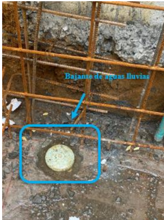
Ilustración 11. Bajante aguas lluvia mal ubicado Fuente: Elaboración propia
