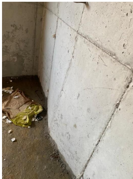
Ilustración 52. Barriga en muro de concreto por falla de corbata
