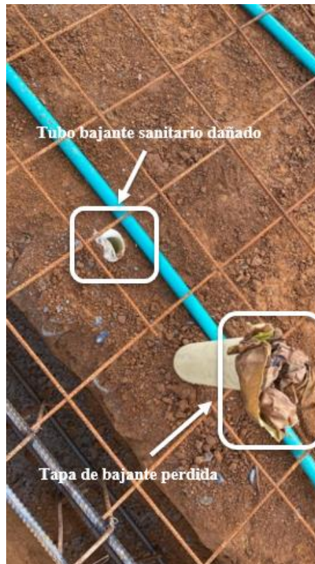
Ilustración 12. Irregularidades en tubería sanitaria Fuente: Elaboración propia
