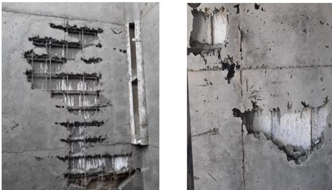
Figura 31. Problemas de homogeneidad en los muros generados por mal vibrado de concreto.
