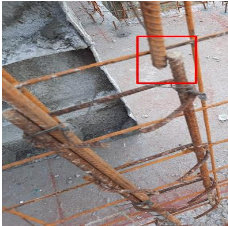
Figura 11. Problema con empalme de barras.
