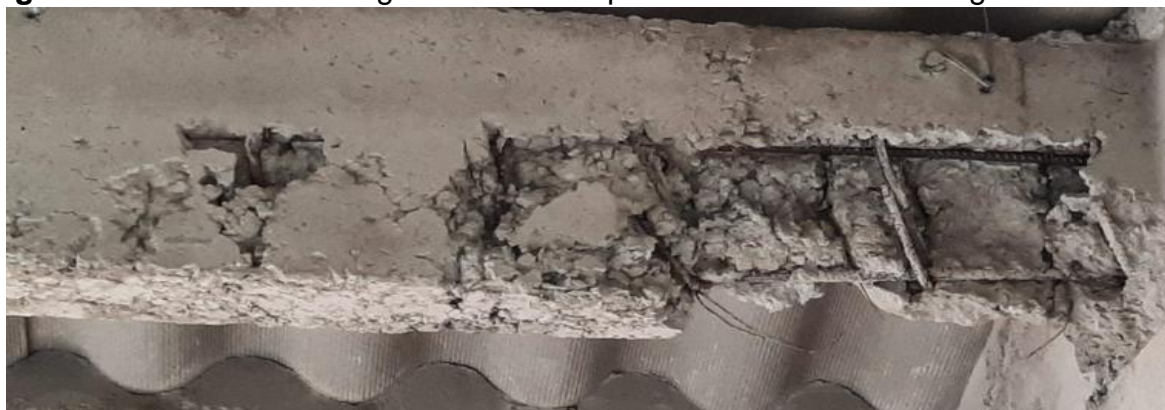
Figura 33. Problemas en vigas de refuerzo por mal vibrado del hormigón.
