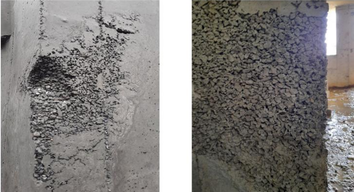
Figura 30. Segregación del concreto en muros.
