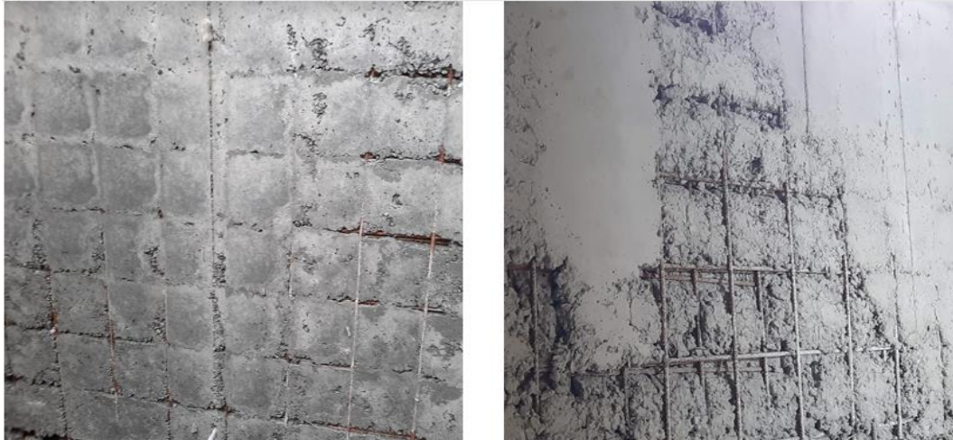
Figura 13. Acero de refuerzo sin recubrimiento de concreto.
