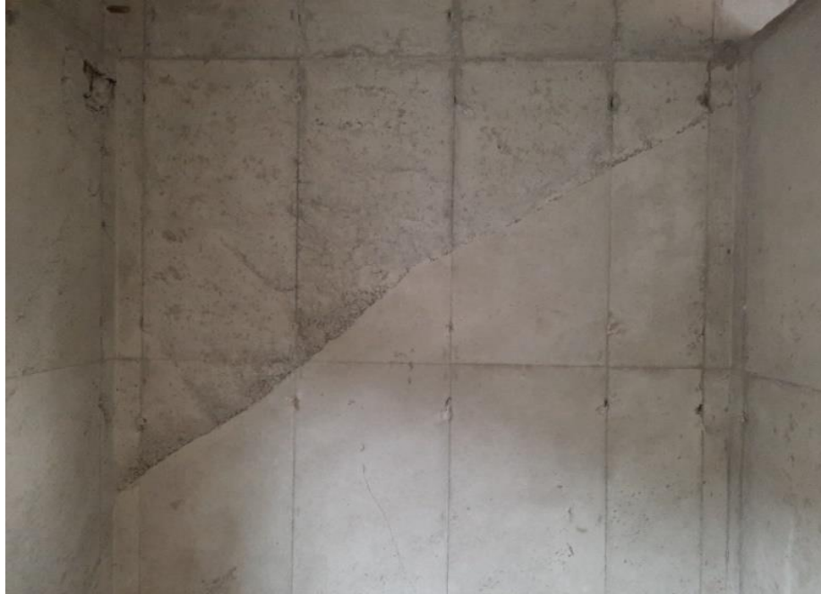
Figura 49. Junta fría en muro.
