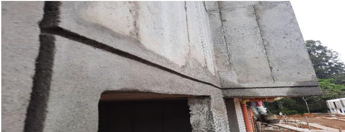
Figura 40. Dilaciones estructurales en la fachada.
