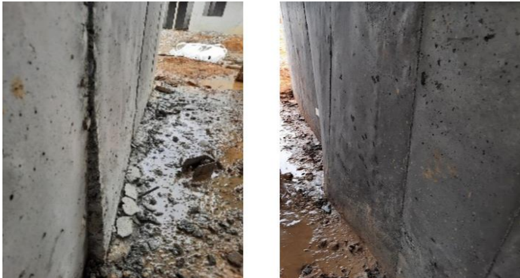
Figura 24. Muros deformados por el desajuste o fallo de corbatas.
