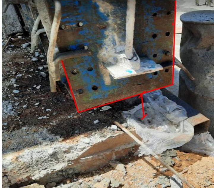
Figura 6. Problemas generados por los desniveles en la cimentación.
