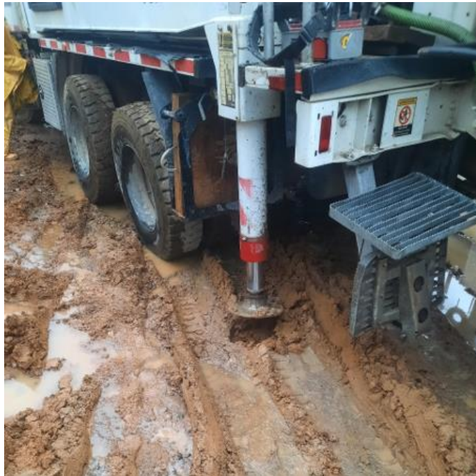
Figura 50. Problemas de estabilización de autobombas en terreno inestable.
