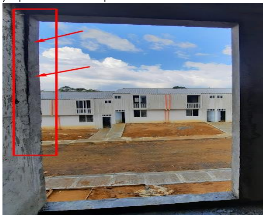
Figura 39. Ejemplo de un mal revoque en bordes de muro.
