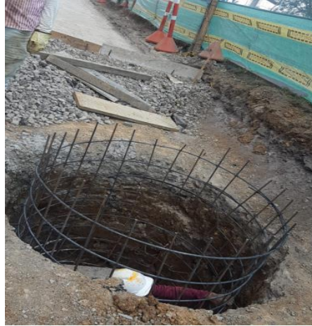
Ilustración 43. Hierro cámara inspección pluvial eje 8 Fuente: Autor
