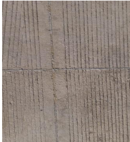
Ilustración 81. Juntas con material de sello. Fuente: Autor
