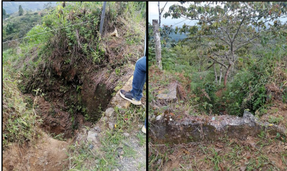
Figura 57. Visita a la vereda San Rafael y estado de alcantarillas
